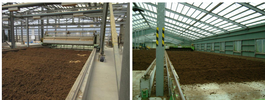
左 関東 下水脱水ケーキの堆肥化発酵プラント 右 九州 牛糞の堆肥化発酵プラント
